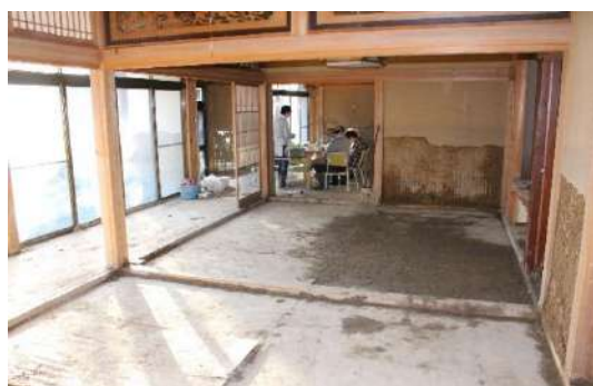
畳やふすまが撤去された庫裡の様子
